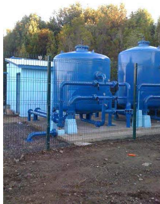
Agua Potable Huillinco
